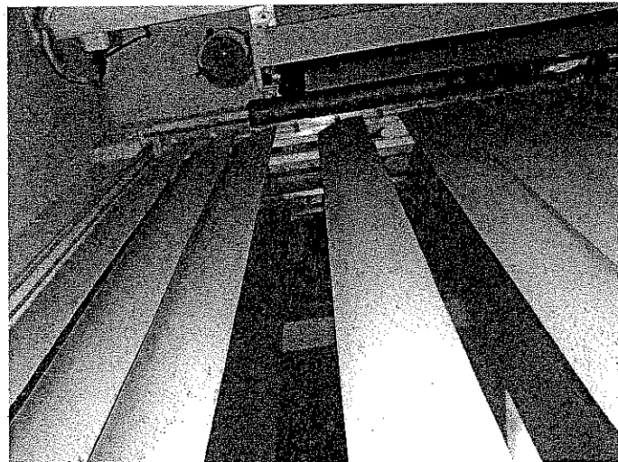
AFECTACION DE MURO EN VENTANA
